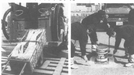
毎月第1・3日曜日には、 消火栓の点検などを行います
